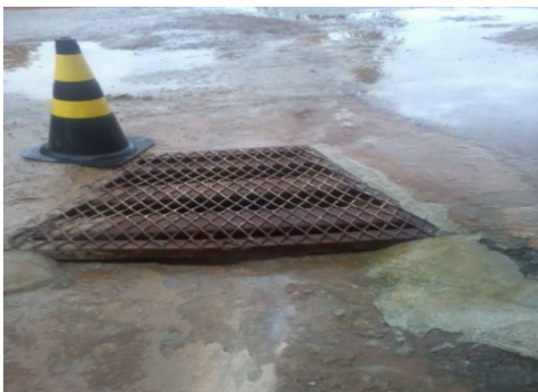
Figura 1: efluentes líquidos pluviais em solo lixiviando o material para o solo exposto.
