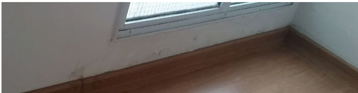
Figura 15. Manifestações patológicas incidentes na pintura do empreendimento B
