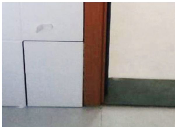
Figura 16. Falta de rejunte encontrado nas vistorias no empreendimento B
